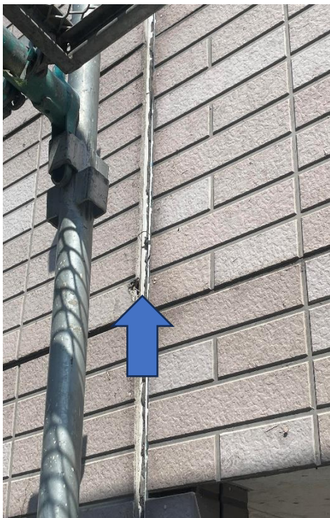
コーキングが切れた状態
